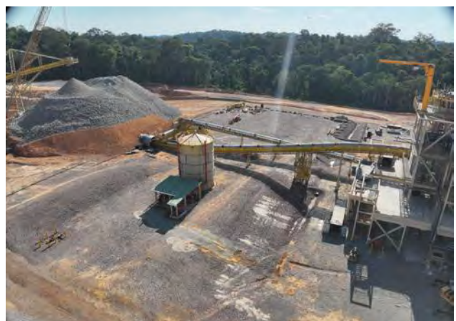
Área de estocagem e transporte do minério
